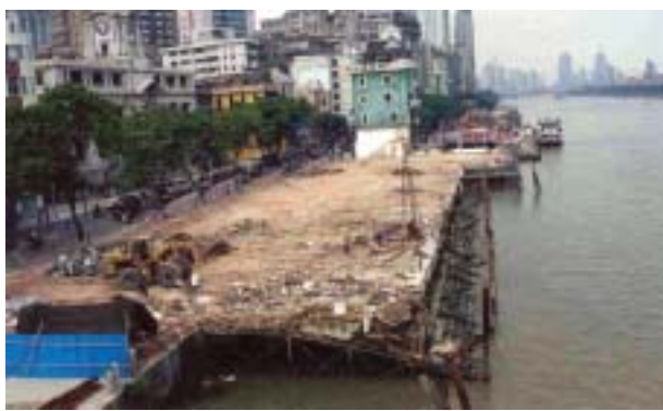
圖 10 - 荔灣區珠江江畔舊碼頭區清拆以騰出土地作行人堤岸及綠化設施
